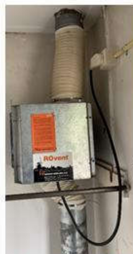
Mechanische ventilatie (MV-Box)
